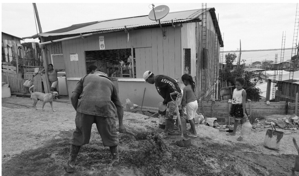
Figura 14. Vivienda en construcción con las mismas deficiencias que las destruidas por el sismo. Un año después del sismo.
