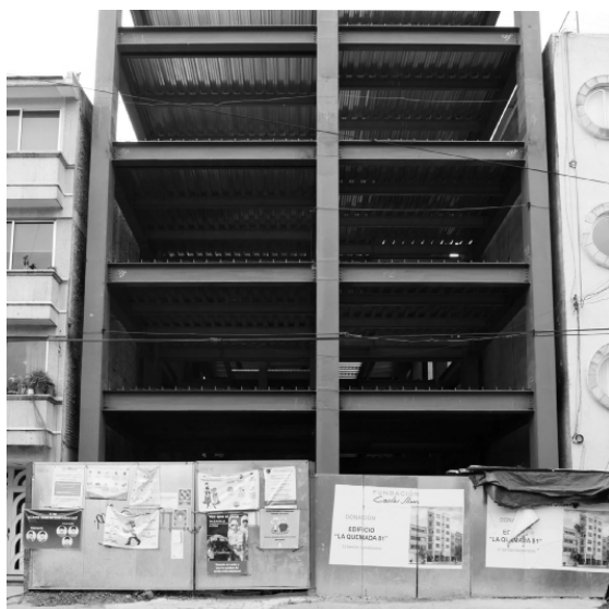
Figura 2. Reconstrucción de edificio por Fundación Slim, calle La Quemada, Alcaldía Benito Juárez, Ciudad de México. Fuente: Elaboración propia, agosto 2020.
